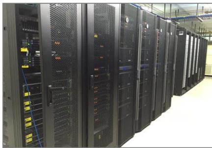
[서버실 내부 전경]
